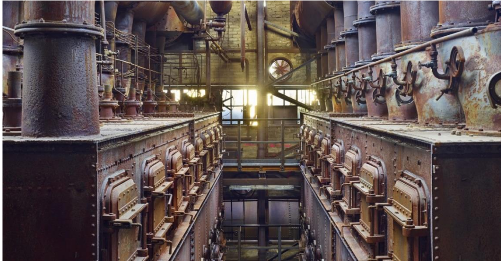
Figura 5.11. Sala de limpieza de gas
