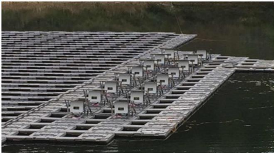
Figura 2-10. Inversores de string instalados sobre estructuras de flotación. [23]
