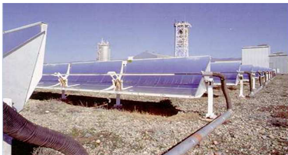
Figura 1: Campo de colectores distribuidos ACUREX
