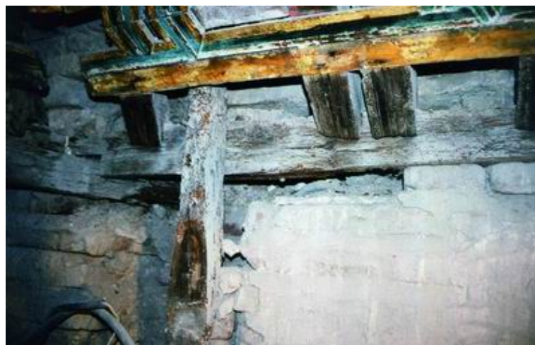
Foto 3 4. Todos los encuentros entre elementos constructivos de la armadura y muros de carga se hallan deteriorados.
