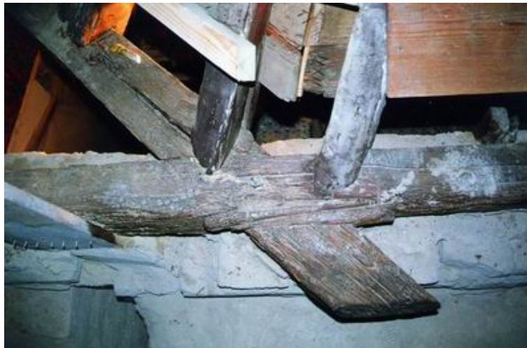
Foto 8 y 9. La falta de material como fruto del ataque de agentes biológicos ha reducido notablemente la resistencia de la viga que estando fija en el otro extremo sufre la contraflecha y la aparición de fendas longitudinales en las zonas de concentración de tensiones.
