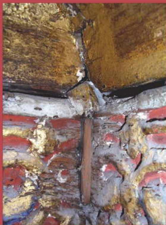
▲ Foto 44. Reparaciones provocadas por ataque de coleópteros.
