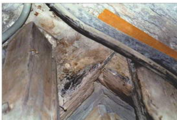
▲ Fotos 5 y 6. Extremo del estribo afectado por el incendio desde la estancia y camaranchón.
