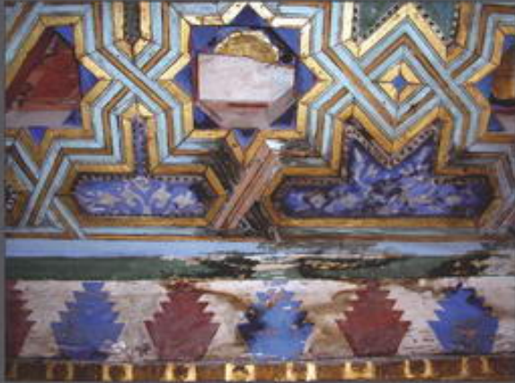
Foto 40. Daños producidos por filtraciones.
