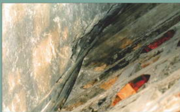
▲ Foto 16. Pendolas afectadas por el incendio de 1762.
