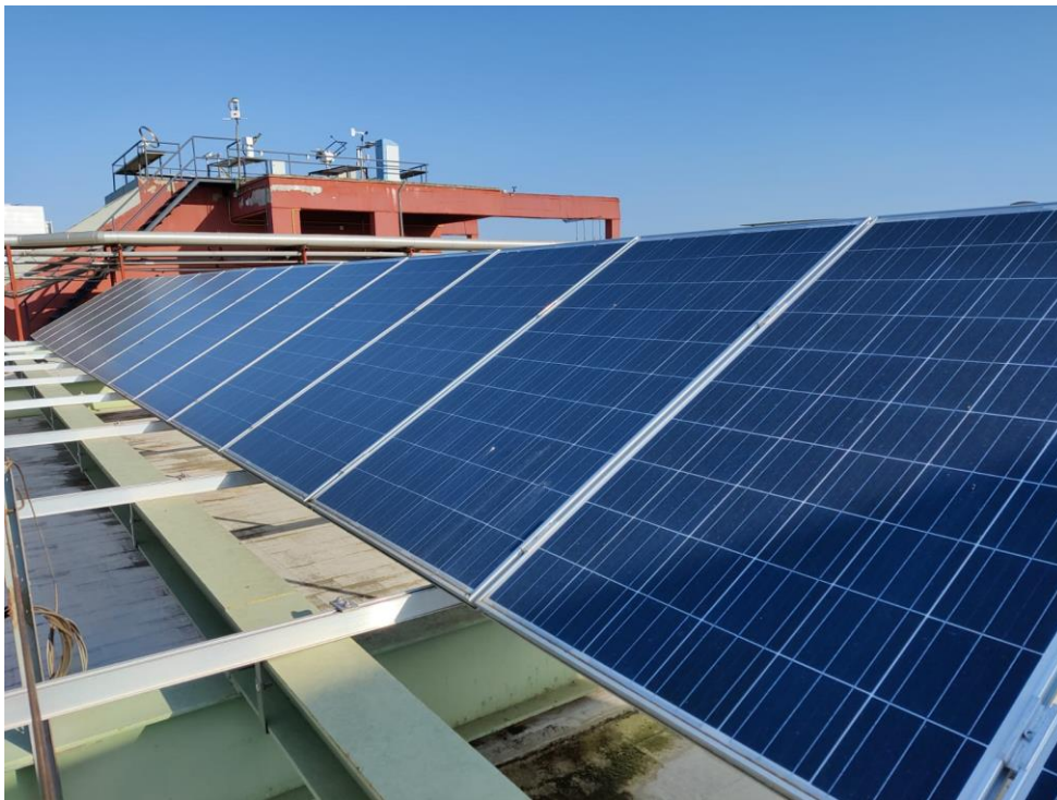
Figura 26. Fotografía del campo solar fotovoltaico de la instalación experimental
