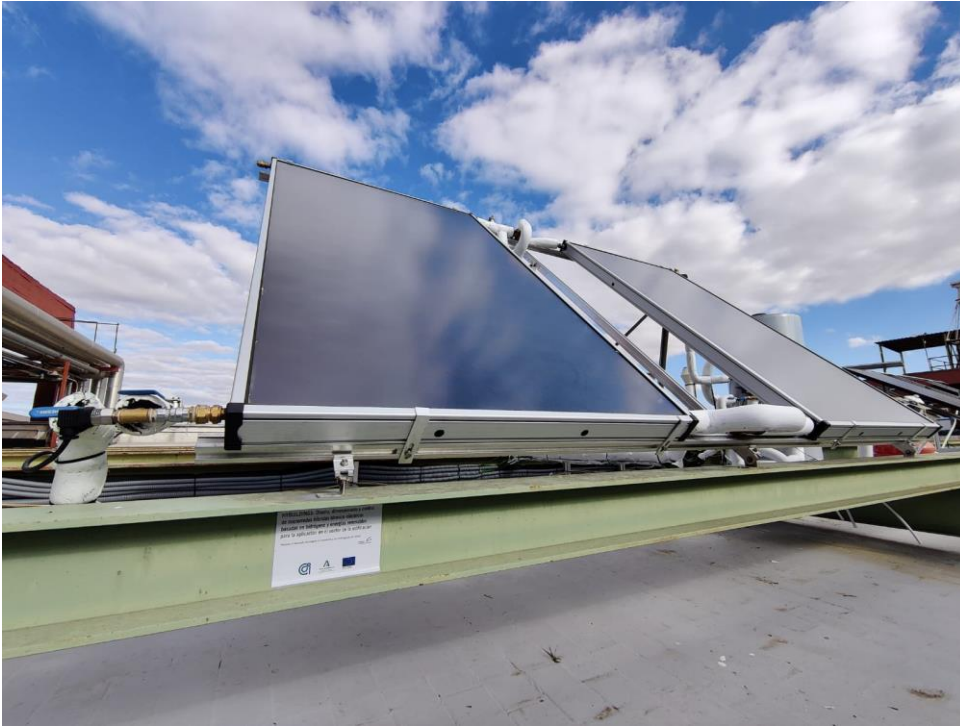
Figura 28. Fotografía los colectores solares térmicos de la instalación experimental.
