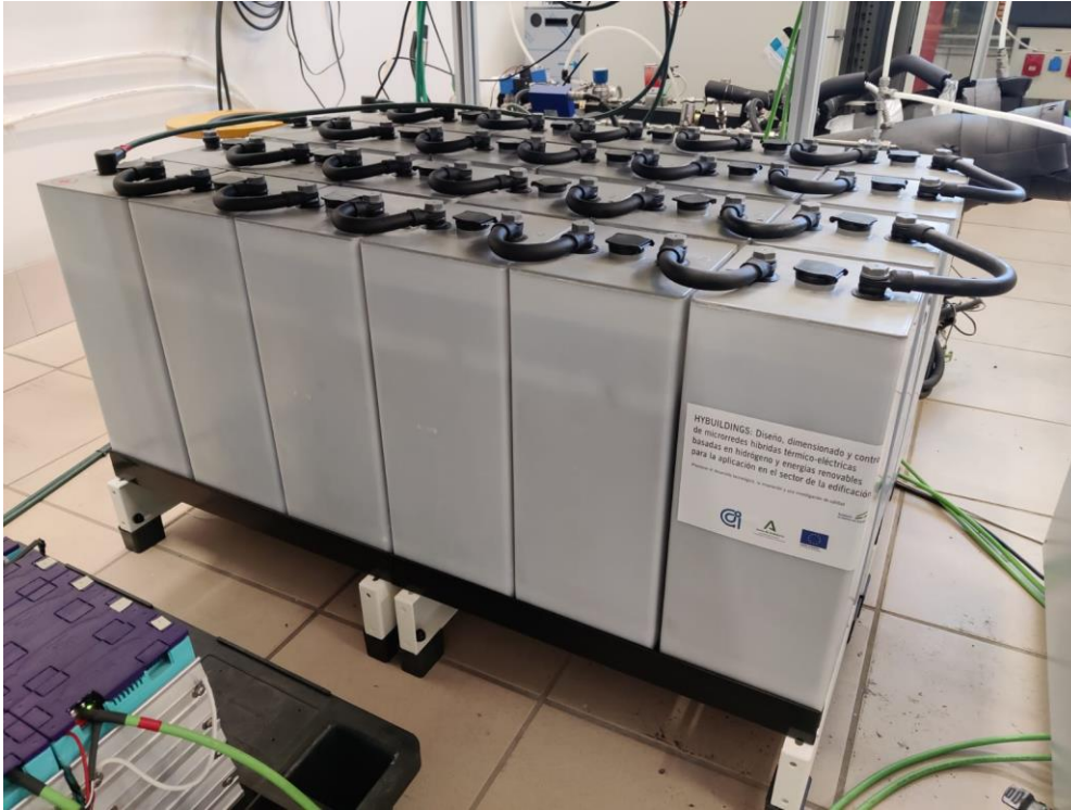
Figura 27. Fotografía de las baterías de plomo-ácido de la instalación experimental.
