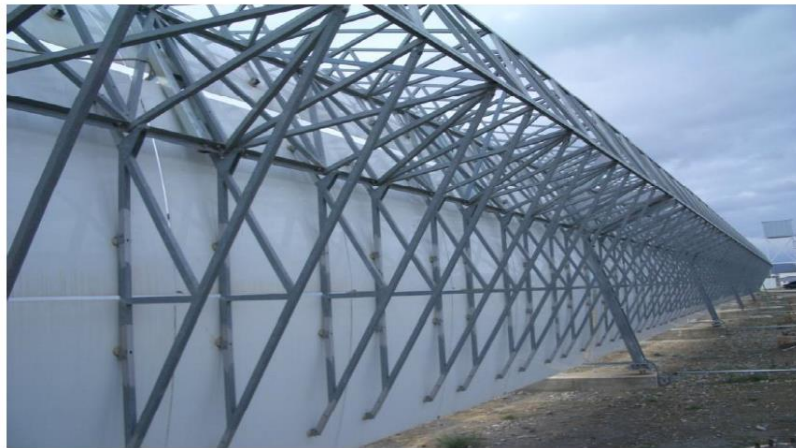
Figura 20.- Estructura soporte de captadores cilindroparabólicos. [4]
