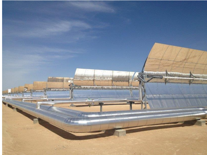
Figura 52. Detalle de captadores en Proyecto Génesis. [33]
