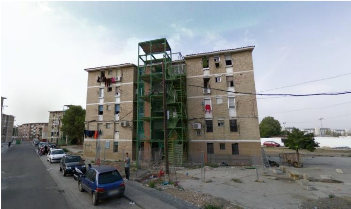
Fig. 18. Fachada principal noreste del bloque 8 en calle Torremolinos, San Martín de Porres, Córdoba, 2008. Obras de rehabilitación integral de la barriada. Fuente: Google Maps, Street View, sept 2008.
