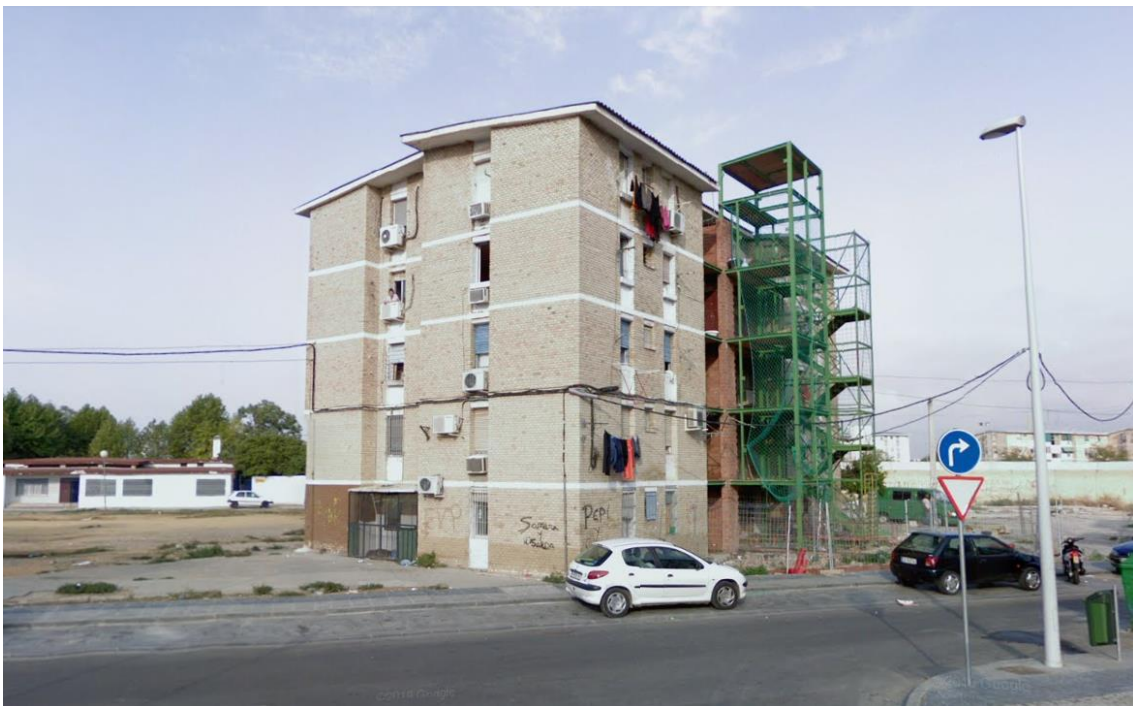
Fig. 19. Fachada lateral sureste del bloque 8 en calle Torremolinos, San Martín de Porres, Córdoba, 2008. Obras de rehabilitación integral de la barriada. Fuente: Google Maps, Street View, sept 2008.
