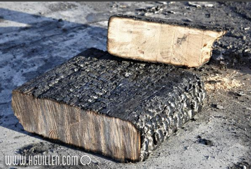
Sección residual de viga de madera laminada con superficie carbonizada tras incendio
