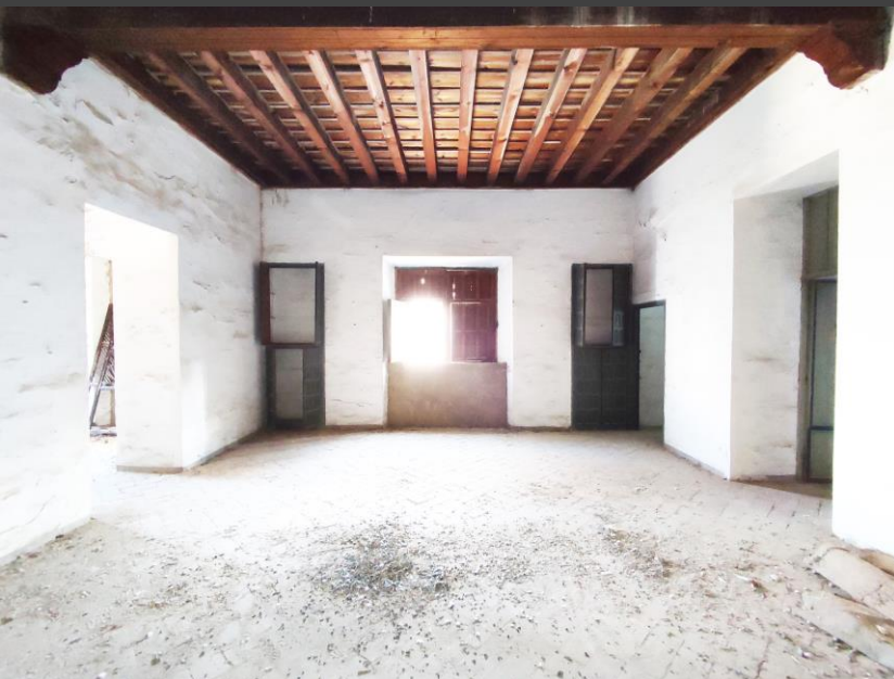
Vista general de la sala 9
