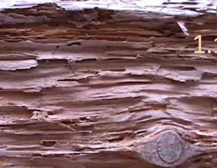
Efectos de las termitas en el interior de una pieza
