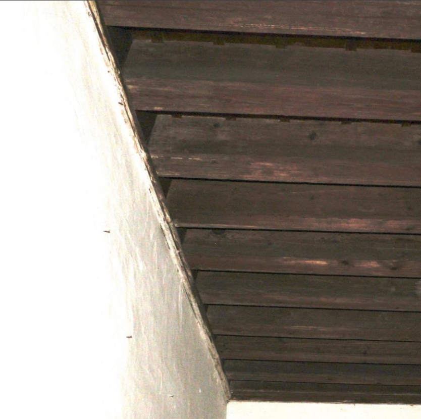
Tabicas en encuentro con muro en alfarje de sala 1
