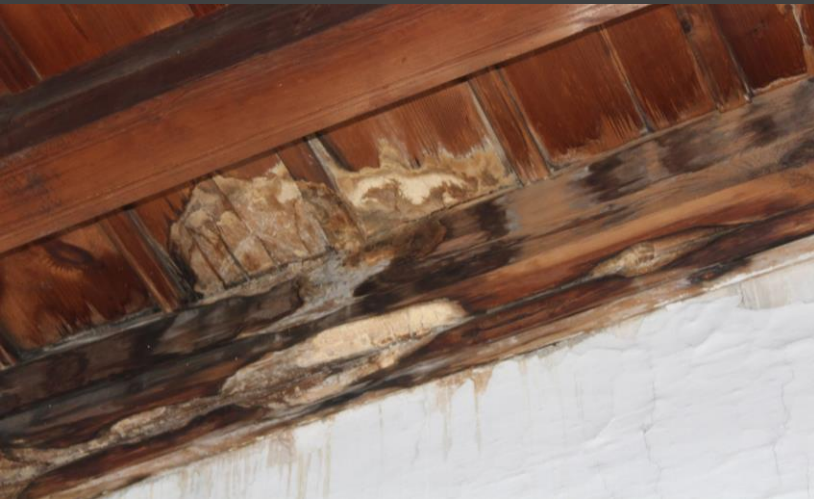
Pudrición localizada afectando a cabeza de jaldeta y tablazón, sala 9
