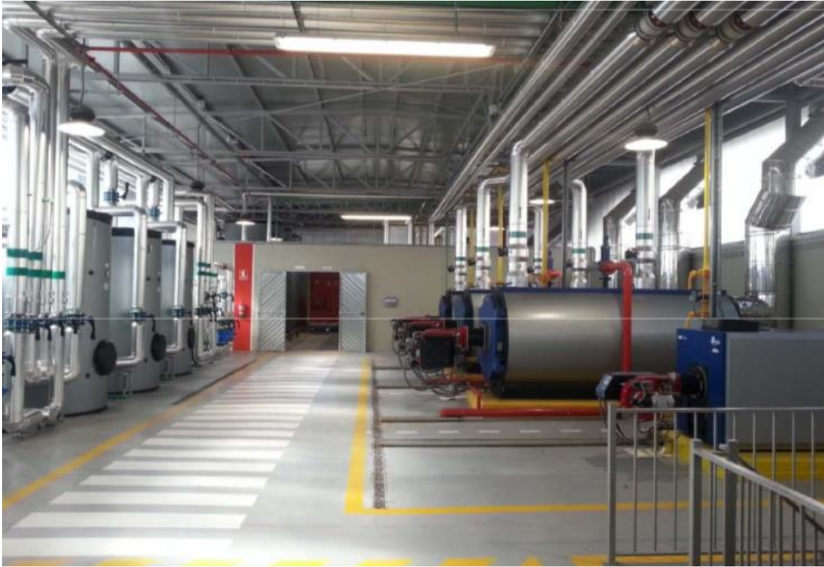
Figura 21. Interior de la central térmica
