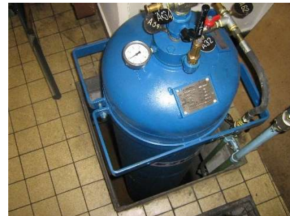
Fig. 14: Botella de aire comprimido para arranque de generador diésel en el metro de París [28]
