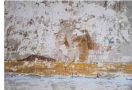
Detalles de la pintura mural de la Torre del Agua: pérdida de película pictórica, perforaciones.
