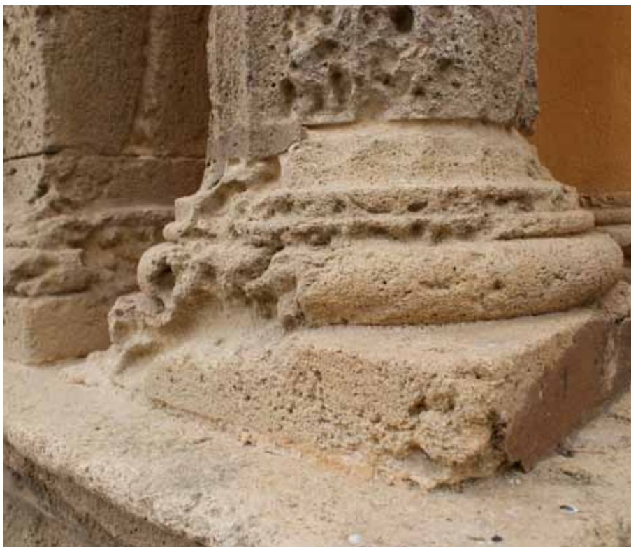
Figura 4a. Detalle del estado de conservación de la Portada, con pérdida de materia generalizada, arenización, picado, o fragmentación en aristas
