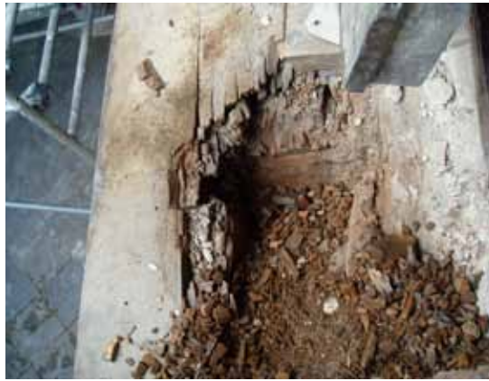
Figura 29. Degradación de una de las vigas de madera, y ejemplos de sustitución de viga, vigueta y pilar
