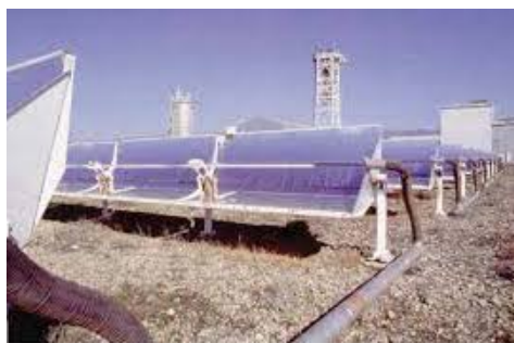
(b) Detalle de colectores solares [8].
