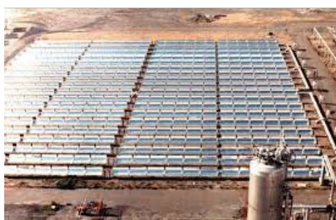
(a) Vista general de la instalación [87].
