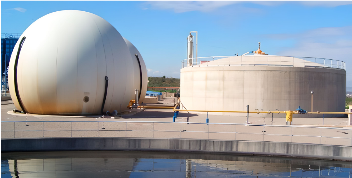
Ilustración 9 Digestor (derecha) y depósito de biogás (izquierda) EDAR Cabezo Beza (Cartagena, Murcia) [14]
