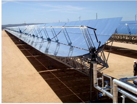
Figura 1.8 Central Termosolar de canales parabólicos de «La Africana» promovida por el grupo Magtel.
