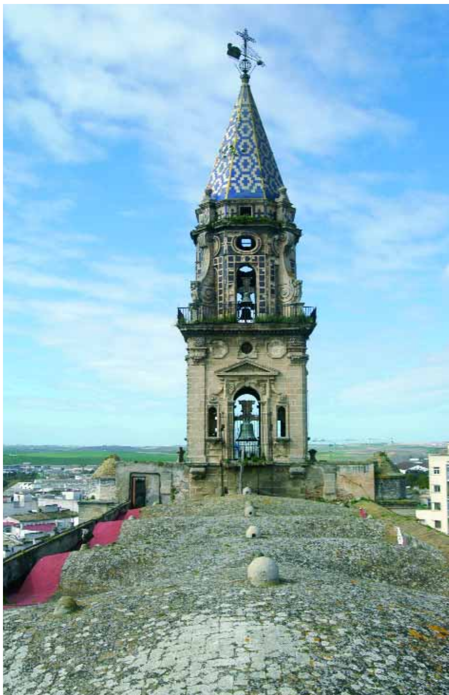
Cubiertas y torre de la Iglesia de San Miguel. Foto: Eugenio Fernández Ruiz
