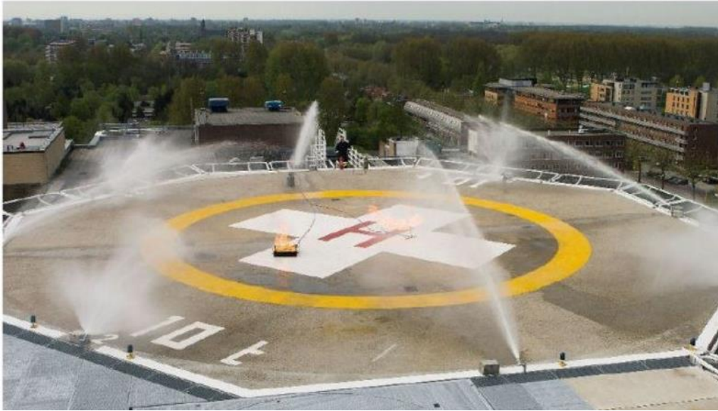
Ilustración 82. Sistema antiincendios de un helipuerto elevado en funcionamiento.
