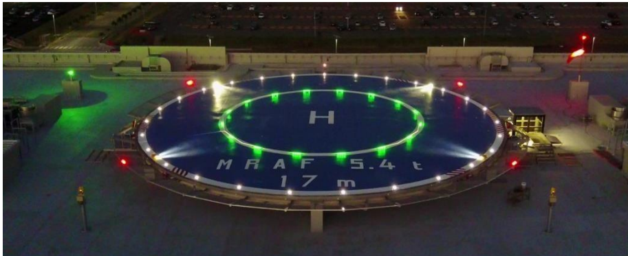
Ilustración 67. Iluminación de un helipuerto.
