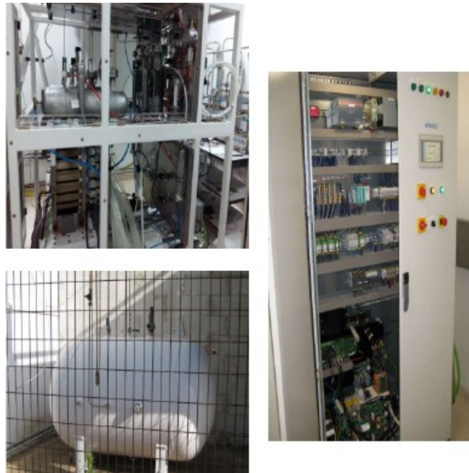
Figura 3.6 Electrolizador y depósito de hidrógeno. Fuente: INTA.
