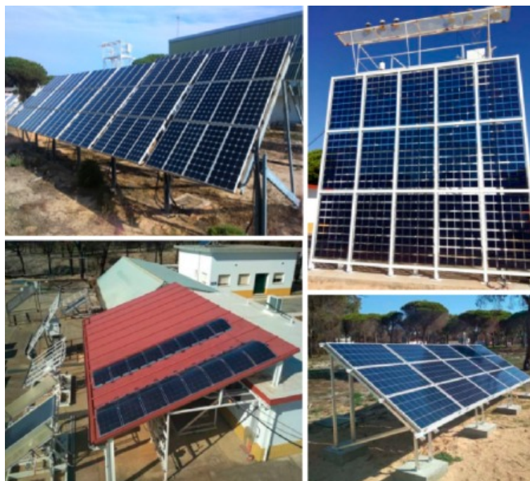
Figura 3.3 Campos fotovoltaicos. Fuente: INTA.
