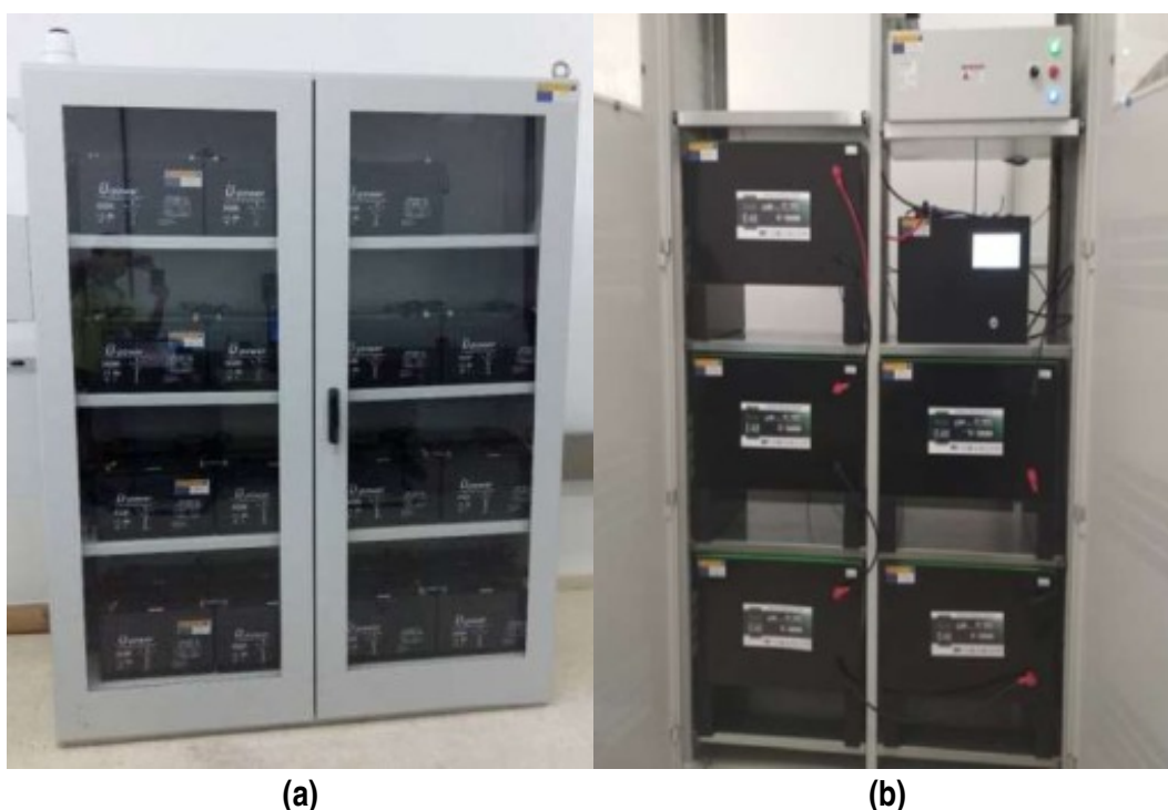
Figura 3.5 Baterías de plomo y litio. Fuente: INTA.
