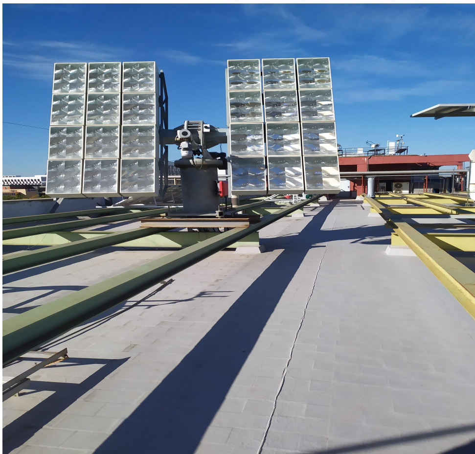
Figura 2-3 Seguidor real del proyecto con los 24 paneles
