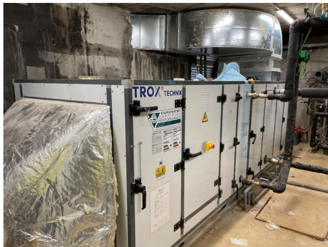
Figura 3-2. Unidad de tratamiento de aire empleada en la sala de máquinas
