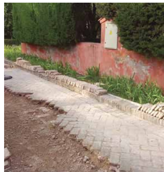
Figura 30. Trabajos de reparación de pavimento de ladrillo en camino junto al Cenador del León, procediendo al recibido y rellagueado del mismo y dotándolo de una mayor pendiente hacia los jardines para evitar la formación de charcos. También se han colocado tubos pasantes para instalaciones para intervenciones futuras. (Juan Manuel Macías)
