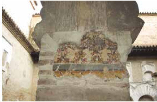
Figura 37. Vistas de la pintura mural de la galería del Patio del Yeso recubierta de deyecciones, y de la misma donde se distinguen los tirantes sobre los que se posan las aves. (Rocío Campos)
