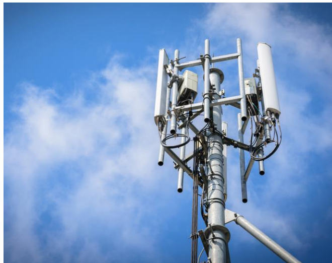
Figura 18. Antena de telecomunicación
