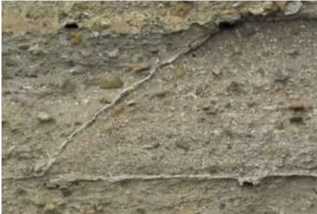
Imagen 37: Detalle de junta inclinada en la Muralla de Marchena (Sevilla). (Imagen de J Canivell).
