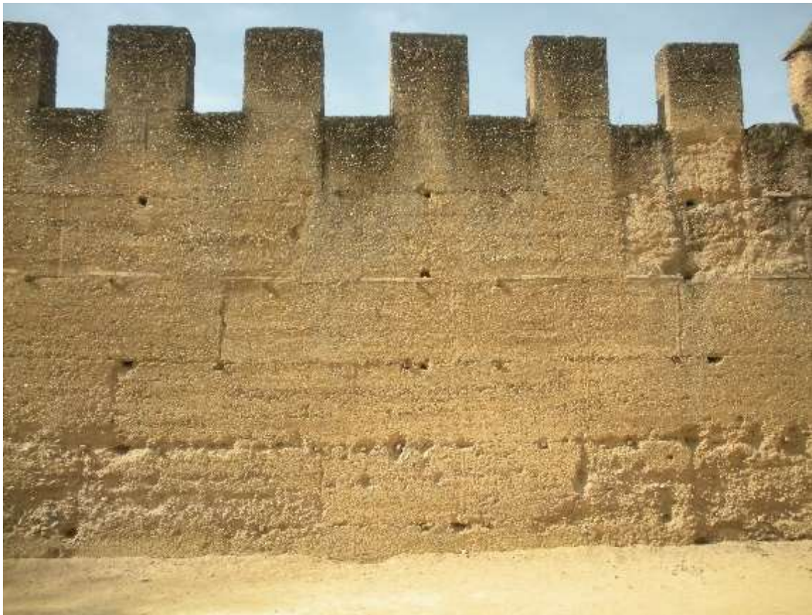
Fotografías 64: Tapia acerada con grava en tramos de la Muralla Almohade de Sevilla -Jardines del Valle-.
