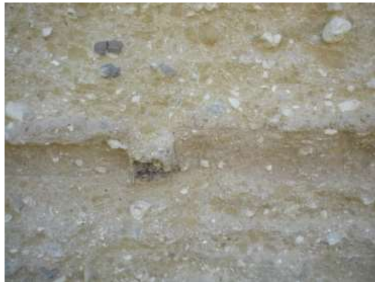
Fotografías 62 y 63: Presencia visible de nódulos de cal en muros de opus caementicium de la Casa de Exedra en Itálica (Santiponce) y en el tapial de Lienzos de la Muralla de Sanlúcar la Mayor.
