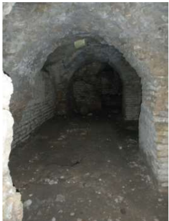
Fotografías 35: La bóveda de cañón donde no se detectan huellas del encofrado utilizado para su ejecución.
