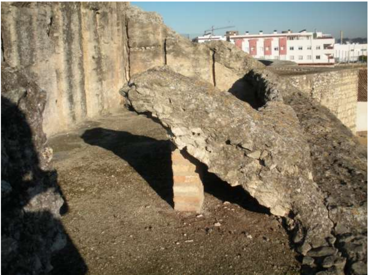
Fotografía 4: Vista de muros, contrafuertes y restos de las losas de la terraza superior del Cerro de San Antonio.
