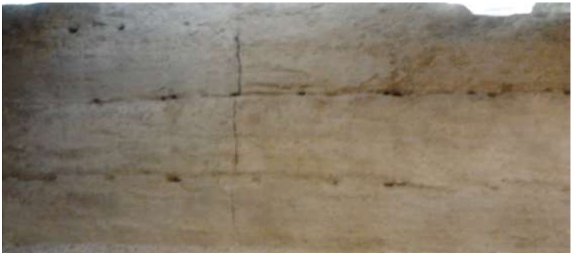
Fotografía 61: Módulo de cajón alto (90 cm) de longitud comprendida entre 2.00 a 2.30 m y con una media de 4 agujas por cajón.
