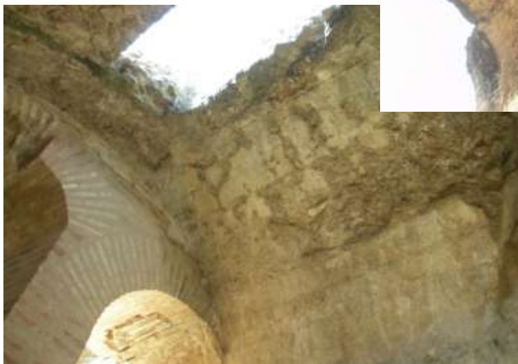
Fotografías 41, 42 y 43: Huellas de los tableros de encofrados en distintas bóvedas de las galerías
