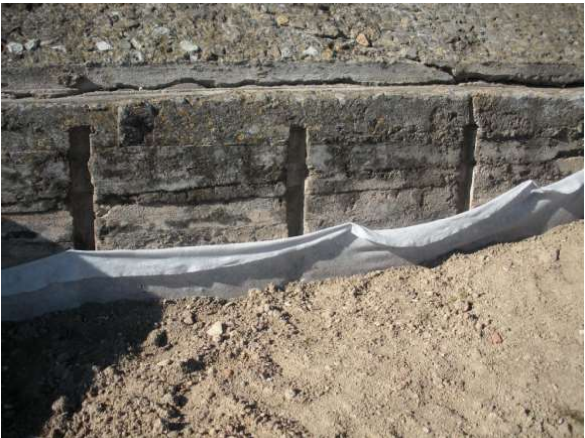
Fotografía 9: Huellas verticales de los costales no enrasadas con los tableros.
