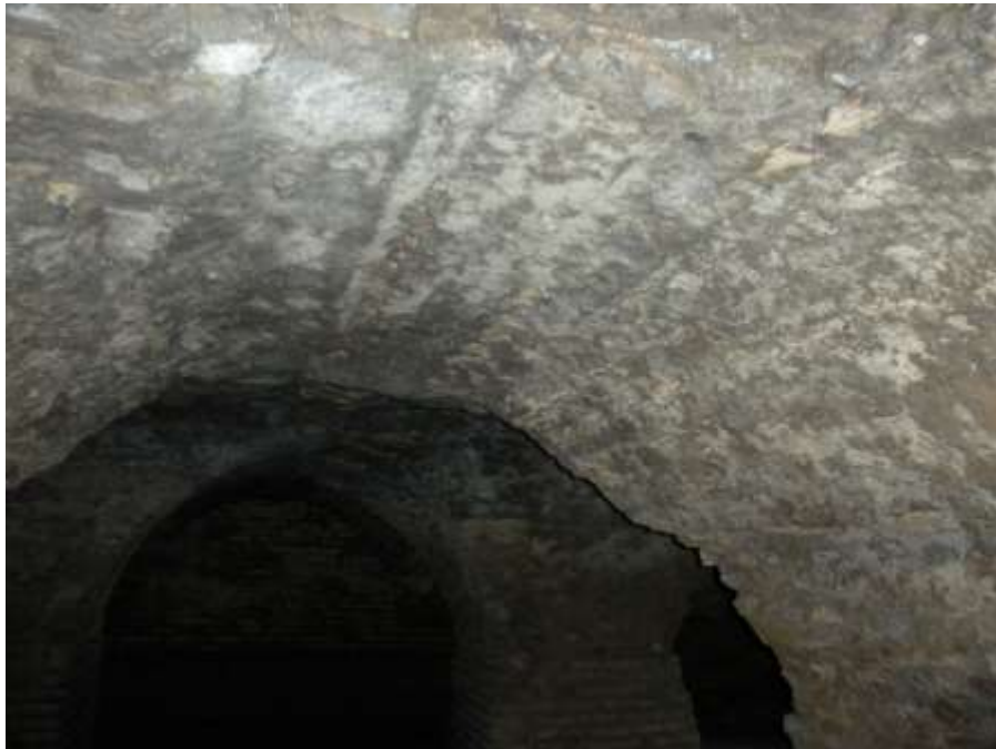
Fotografías 34: Huellas del encofrado de madera empleado en las bóvedas ejecutadas en opus caementicium sin apisonar
