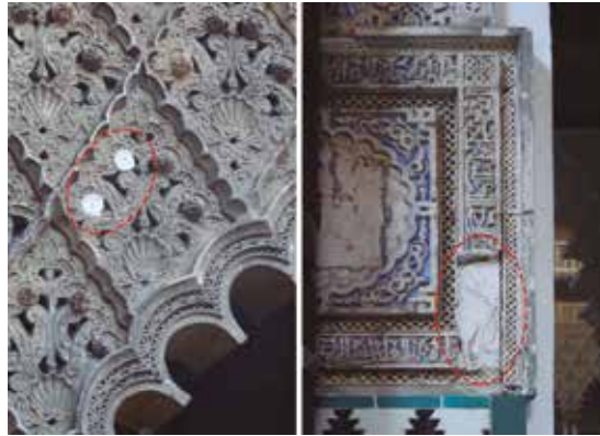
Figura 9. Patologías de las yeserías del Patio de las Doncellas: Desprendimiento de piñas en el paño de sebka y desprendimiento de epigrafía en la cenefa del paramento.
