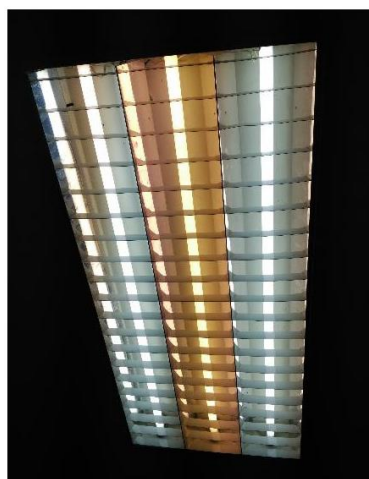
Figura 38. Tubos fluorescentes 3x18 W
