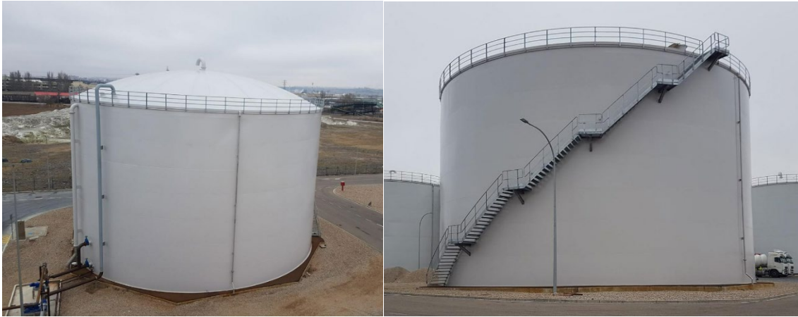
Imagen 18. Tanque aéreo vertical. Fuente: Grupo Cobra, 2022
