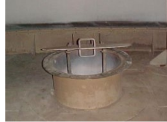
Imagen 36. Boca de hombre sita en la pantalla del tanque. Cedida por empresa del sector.
