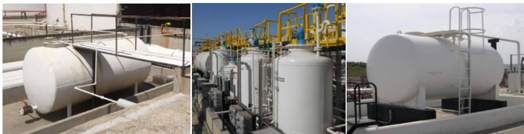
Imagen 20. Depósitos aéreos. Fuente: Cedidas por empresa del sector
