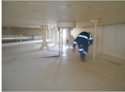
Imagen 34. Ha sido realizada una inspección en las inmediaciones de la pantalla flotante del tanque. Cedida por empresa del sector
