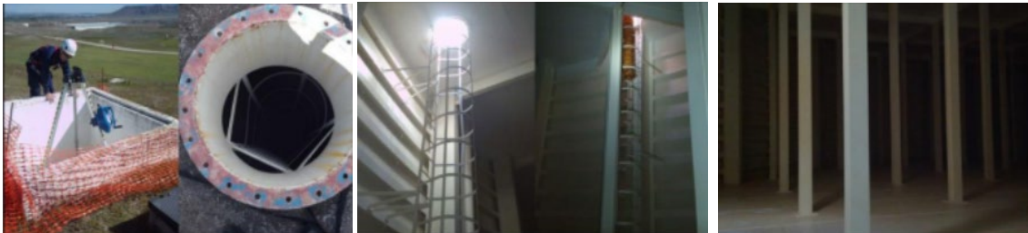
Imagen 19. Exterior, vía de acceso e interior de un tanque enterrado. Fuente: Cedidas por empresa del sector
