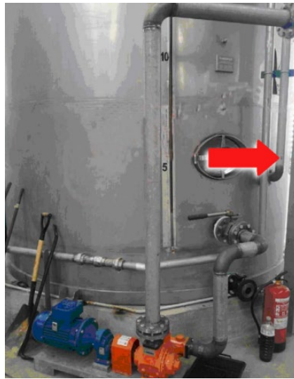
Imagen 13. Tanque donde se produjo el accidente. Fuente: Junta de Andalucía, 2019
