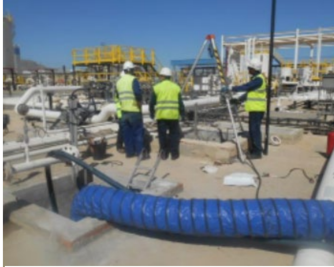
Imagen 31. Ventilación en un recinto confinado. Elaboración propia.
