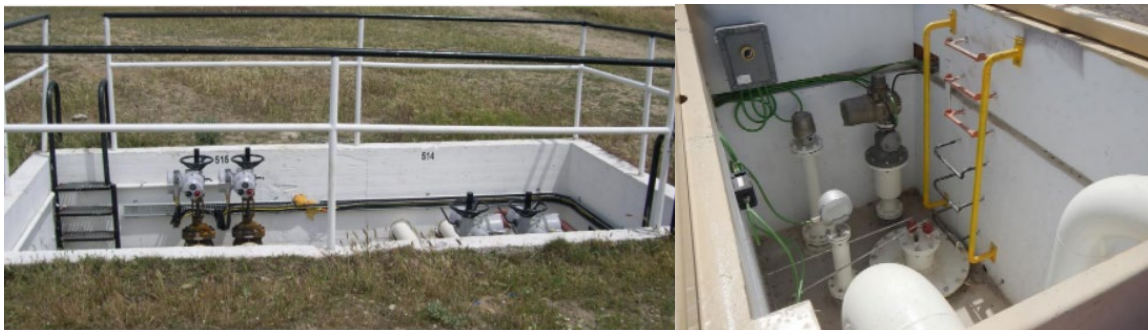
Imagen 25. Arqueta en Instalación Petrolífera de Arahal, Sevilla. Fuente: Cedidas por empresa del sector
