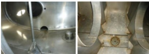
Imagen 23. Detalle del interior de una cisterna compartimentada. Fuente: Cedidas por empresa del sector
