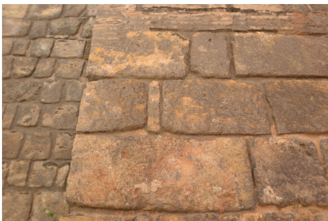
Figura 20. Hiladas de sillares a soga y tizón irregular con tizones y medios tizones esporádicos
