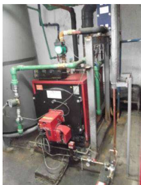
Ilustración 12: Caldera Producción ACS
