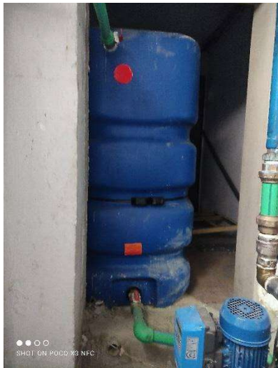
Ilustración 7: Depósitos de Acumulación
