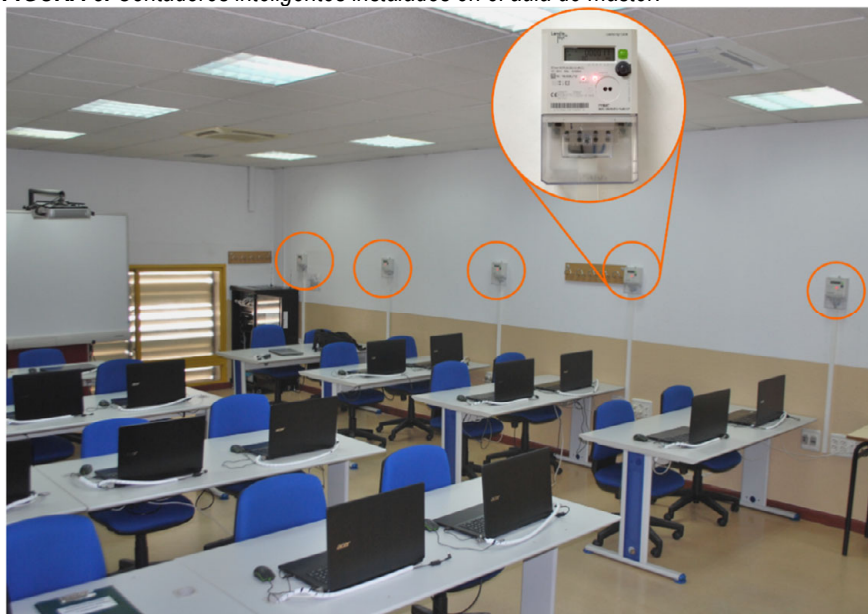
FIGURA 3. Contadores inteligentes instalados en el aula de máster.
