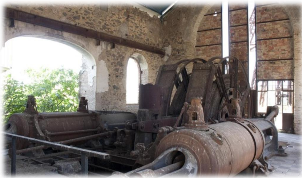
8: Interior de la central eléctrica del pozo nº7 (Domínguez, Francisco José, 2017)
