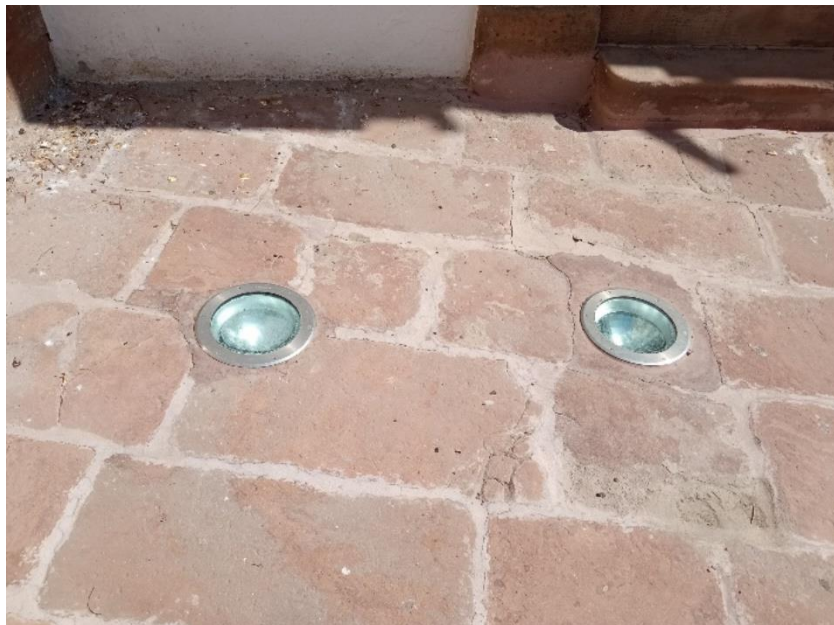
Imagen 2. Dos de los cuatro focos situados en el suelo a la entrada del museo que iluminan la fachada y el entorno de noche. Al fondo a la izquierda, más deyecciones de aves.
