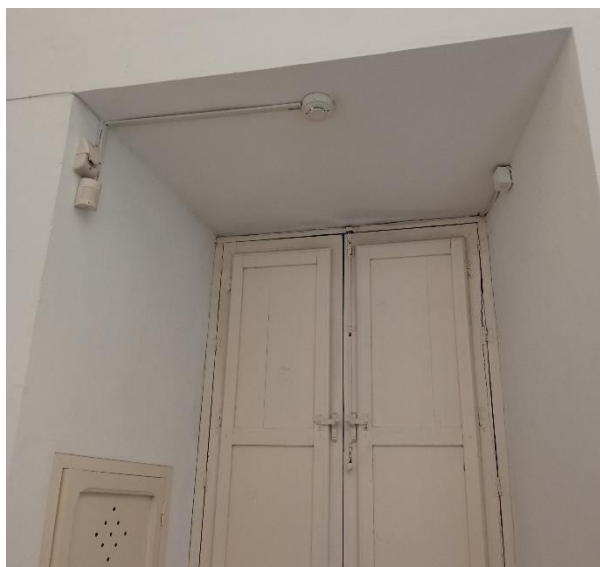
Imagen 2.2. Detector de humos y sensor de movimiento conectados a alarma centralizada.
