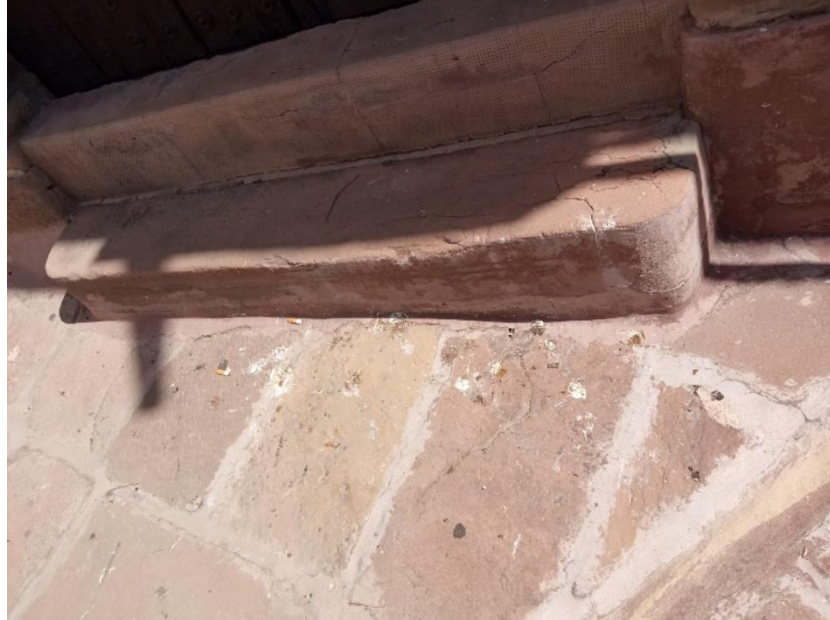
Imagen 1. Detalle de los escalones de la entrada al museo en los que se aprecian deyecciones de ave.
