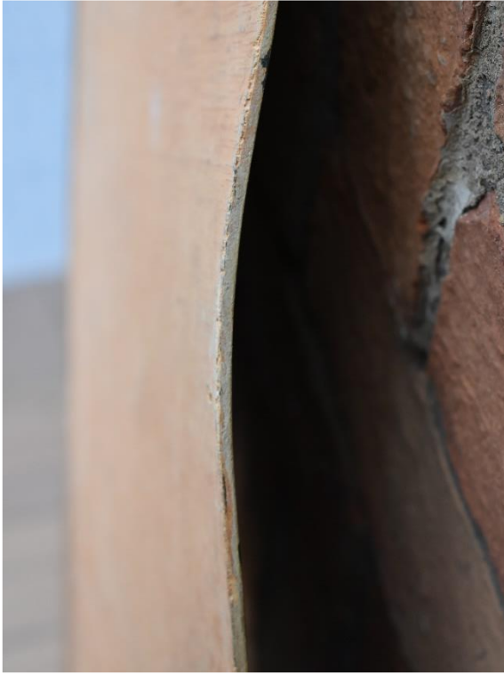
Figura 3: Detalle alabeamiento de la primera tabla. Fotografía: Gloria Rodríguez
