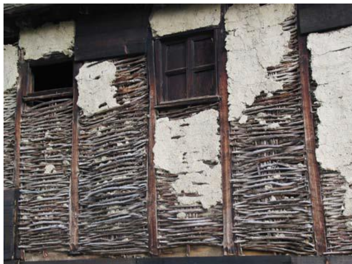
Fig. 18. Solución constructiva de muro tejido con mimbre en Forna, León (España). Fuente: [29]
