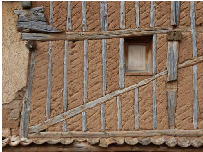
Fig. 17. Solución constructiva de muro entramado con relleno de adobes inclinados en Navapalos, Soria (España). Fuente: [29]
