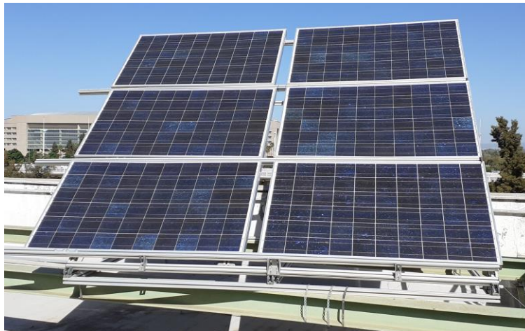
Figura 3-2. Conjunto de placas fotovoltaicas
