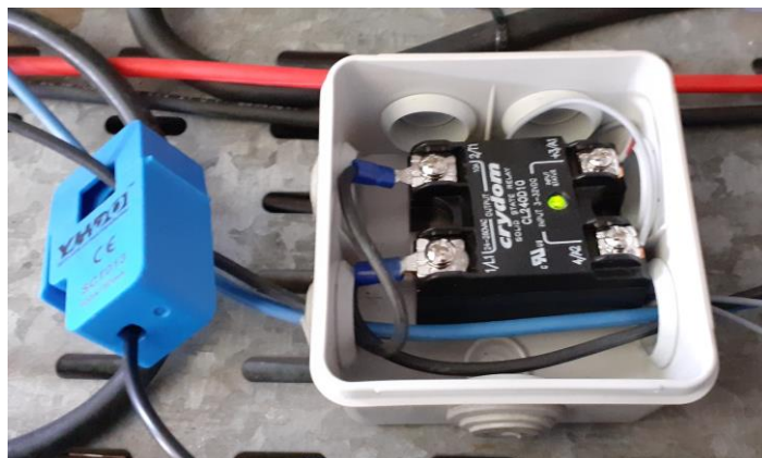
Figura 3-16. Montaje del relé y del sensor SCT-013
