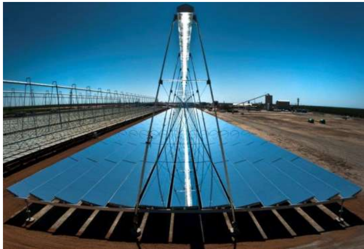
Ilustración 1 - Planta solar tipo Fresnel
