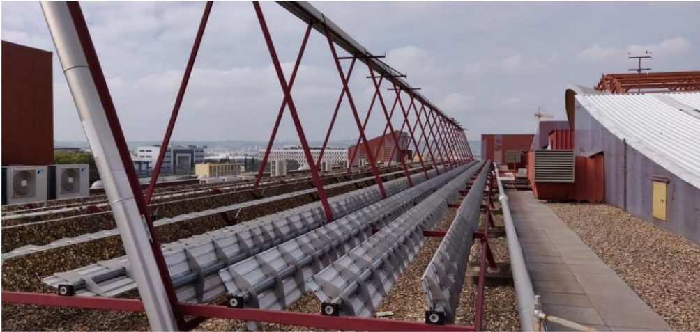
Ilustración 4 - Campo solar de la ETSI
