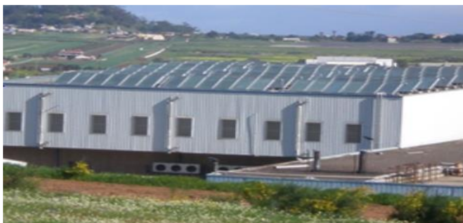
Figura 41. Instalación solar Montesano.
