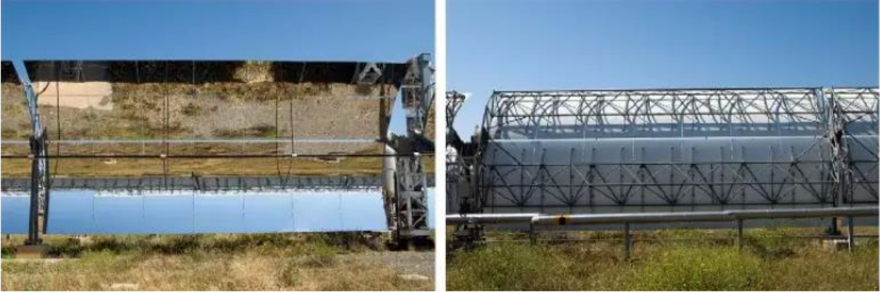
Figura 72. Parte frontal y estructura del colector LS-3.
