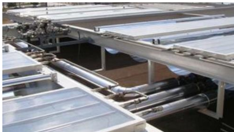
Figura 40. Instalación térmica Pincasa.
