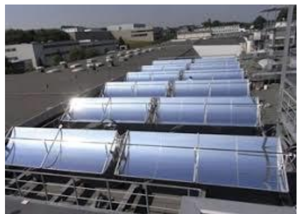
Figura 10. Captadores solares en industria.
