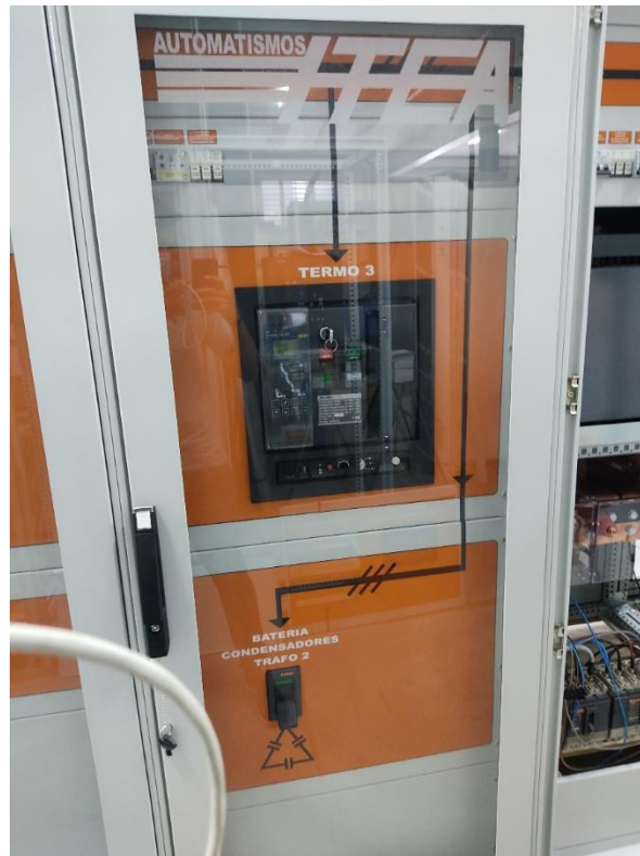
Figura 2.8. Conexión Interruptor-PLC taller (2)
