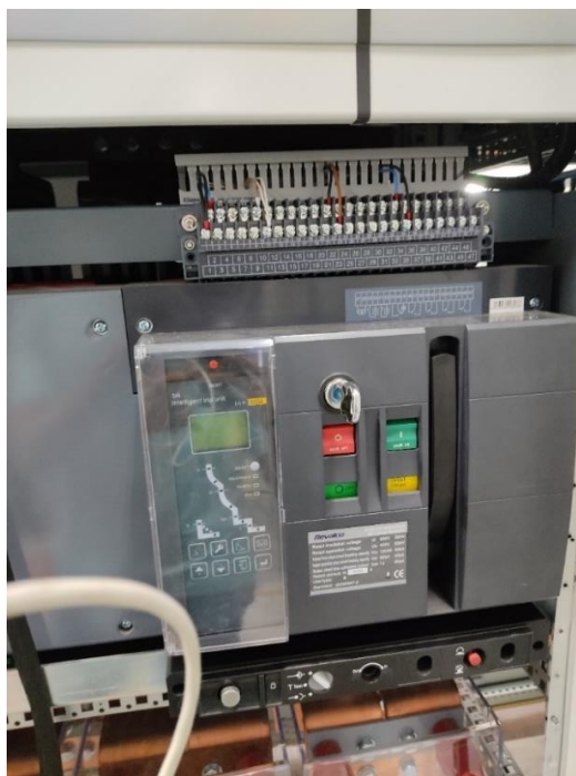
Figura 2.6. Conexión Interruptor-PLC mediante cable de comunicación
