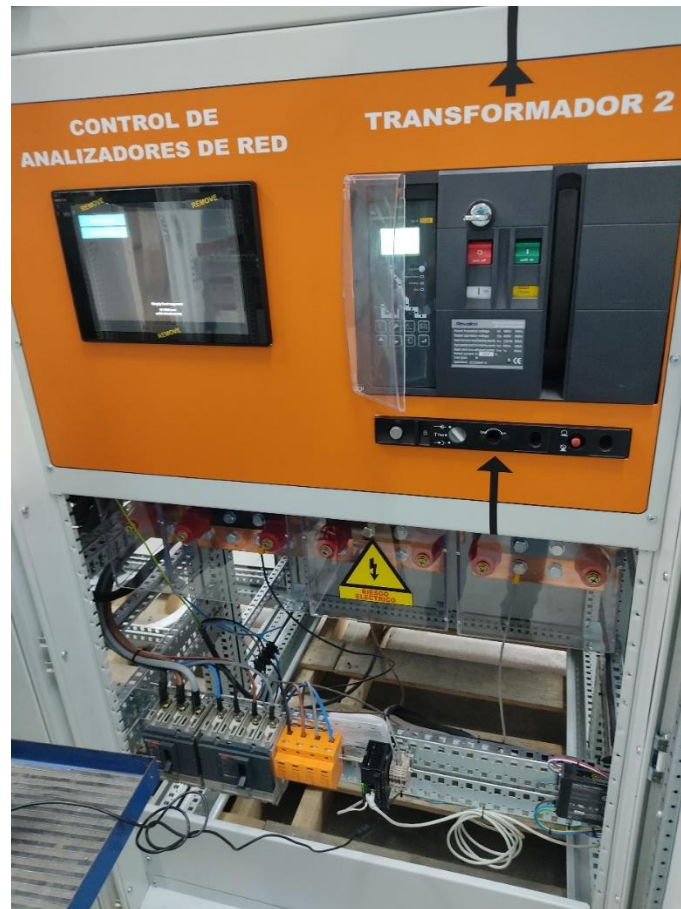
Figura 5.10. Conexión de Pantalla y PLC en el Interruptor
