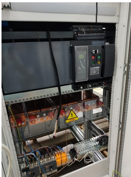
Figura 2.7. Conexión Interruptor-PLC taller
