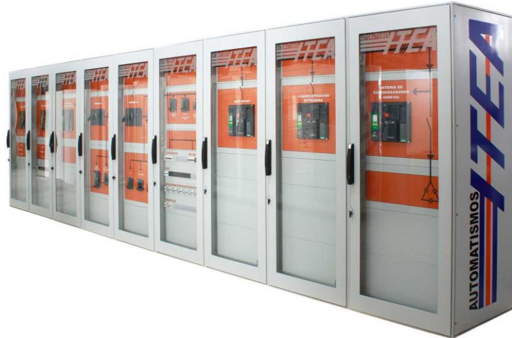
Figura 1.1. Instalación Eléctrica utilizada en el Proyecto
