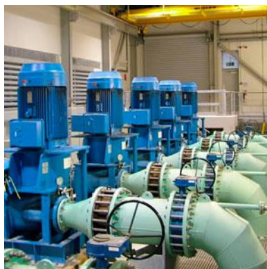
Figura 12 – Equipos de bombeo de agua
