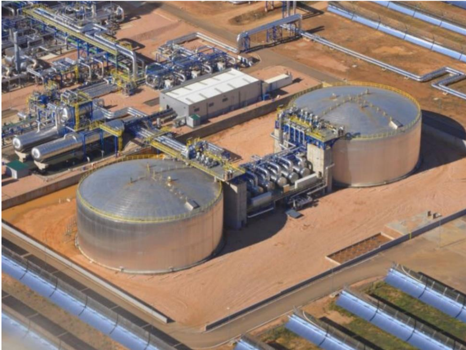
Ilustración 31. Tanques caliente y frío de la central UTE EXTRESOL 1 en Torre de Miguel Sesmero en Badajoz, con 16.300 m 3 de capacidad.
