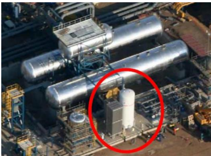
Ilustración 33. Tanque de Hidrógeno en planta CSP. (Prieto, 2021)
