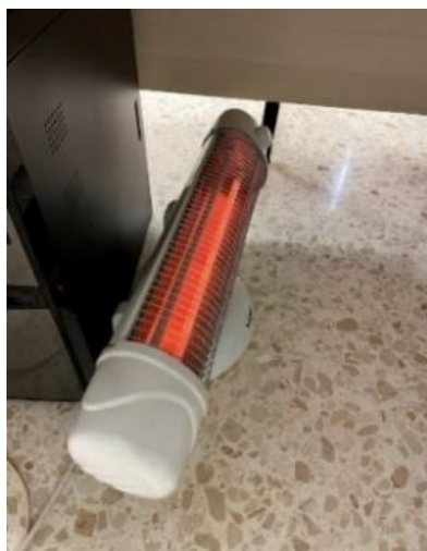
Fig. 18. Calefactor eléctrico infrarrojo bajo mesa de trabajo en local de administración de Retama. Fuente: fotografía realizada por el autor. (Imagen)
