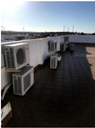
Fig. 17. Unidades exteriores del sistema de expansión directa ubicados en la cubierta del edificio con hueco para la red de conductos por el interior. (Imagen)
