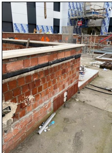
Imagen 2. Estado de la zona
