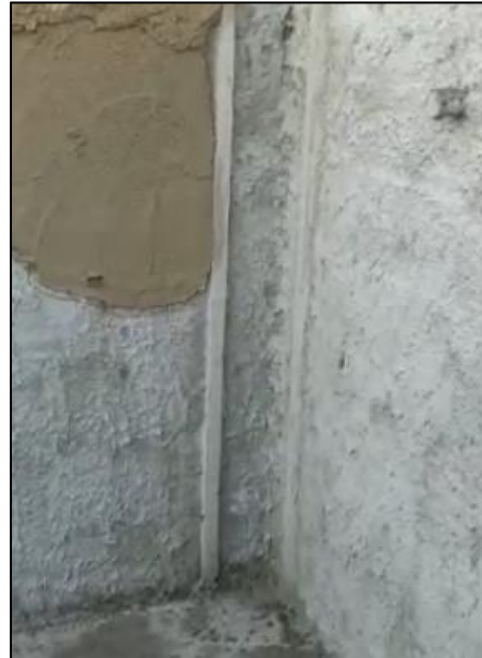
Imagen 2. Estado de la zona
