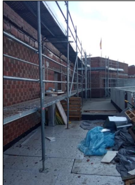
Imagen 2. Estado de la zona
