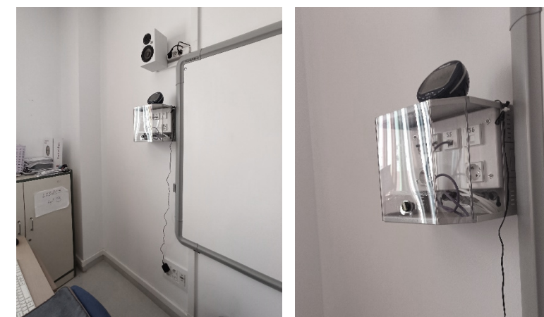
Imagen XX_Posición del controlador ambiental en el aula de 4º de primaria.
