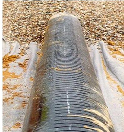
Figura 8. Tubería perforada para la captación del lixiviado.
