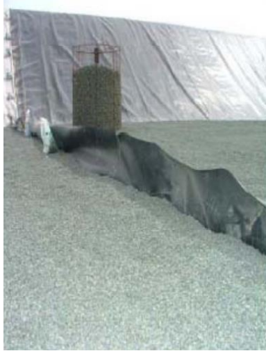
Figura 10. Chimenea para la salida del biogás.
