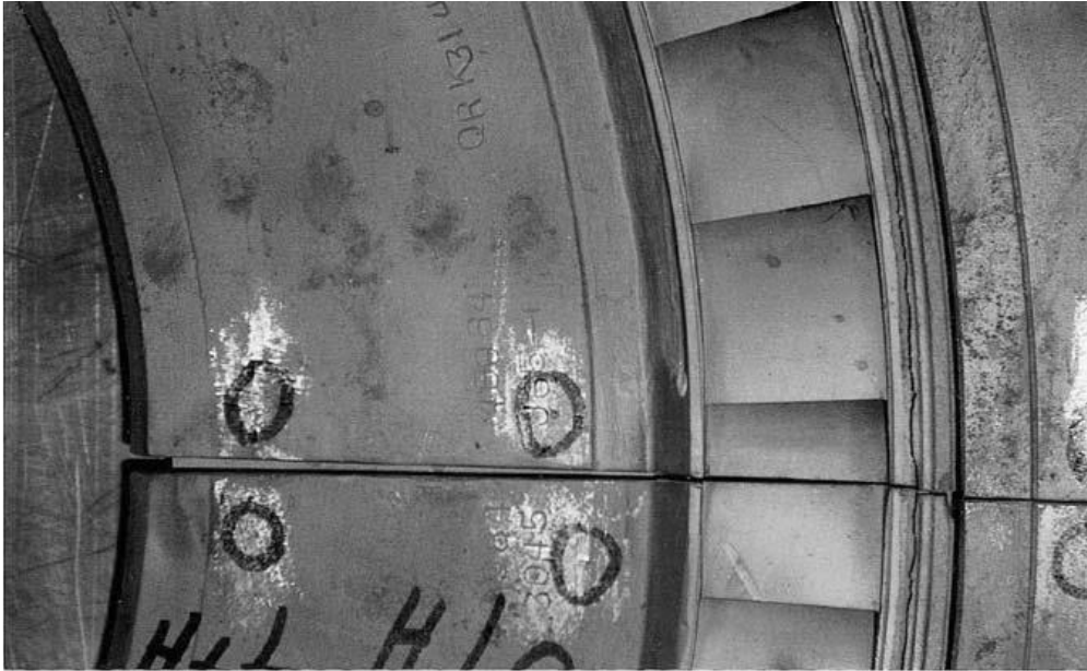
Figura 3-28. Hueco en la junta horizontal del diafragma causada por el movimiento de las mitades hacia adentro debido a la deflexión por fluencia.
