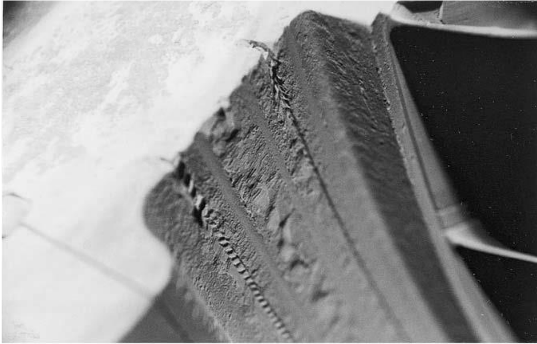
Figura 3-29. Superficie interior de una carcasa en la que la deformación por fluencia la ha desplazado hacia dentro hasta el punto de que los fuertes roces con los sellos integrados en la punta de los álabes giratorios han marcado la carcasa.
