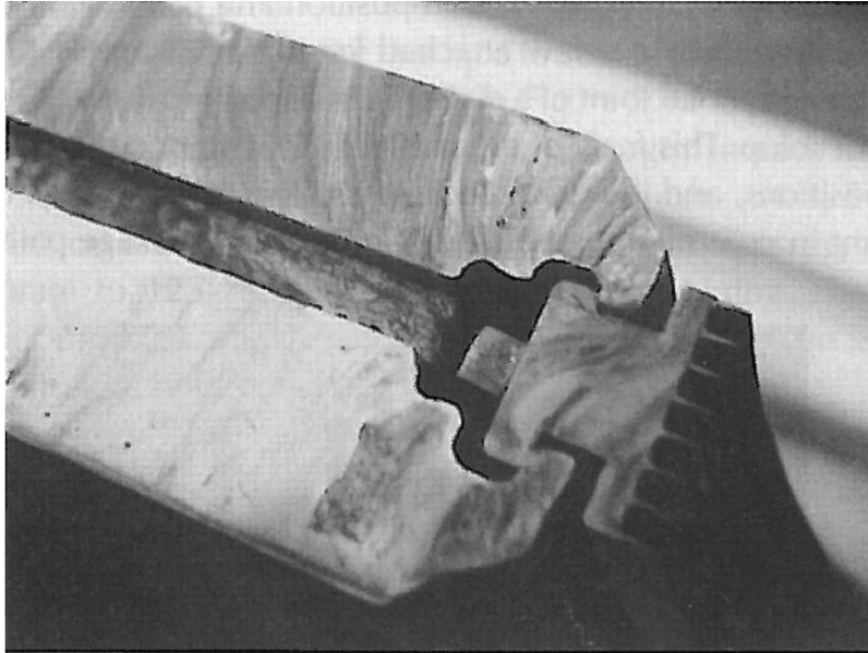
Figura 6-24. Erosión por estrangulamiento en la junta horizontal de un diafragma.
