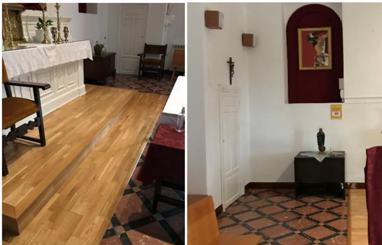
Imagen 37 Izquierda-Entarimado del altar. Derecha-obsolencia de carpinterías e instalaciones vistas. Fuente: Elaboración propia.
