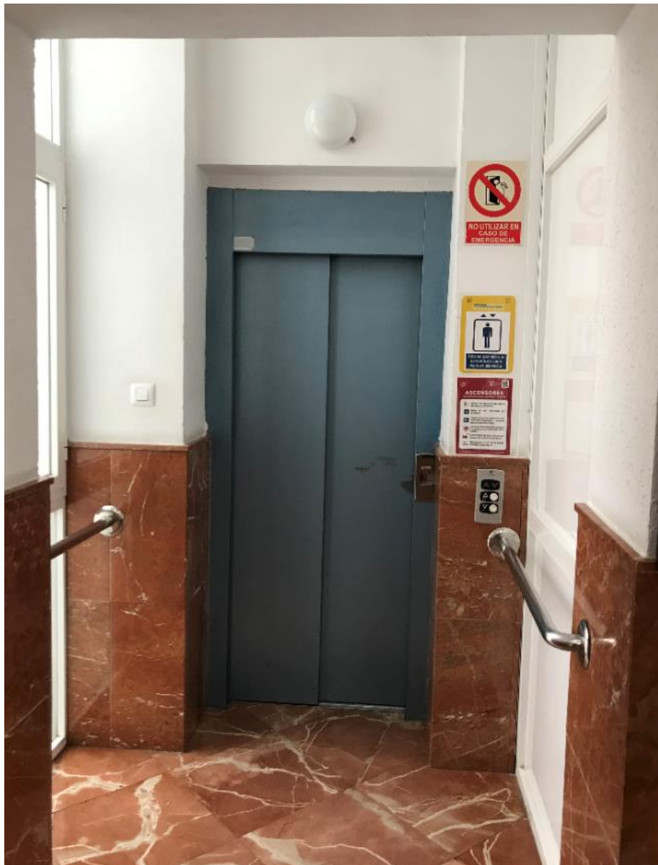
Imagen 30 Colapso del único ascensor que da servicio a los usuarios del edificio. Fuente: Elaboración propia.
