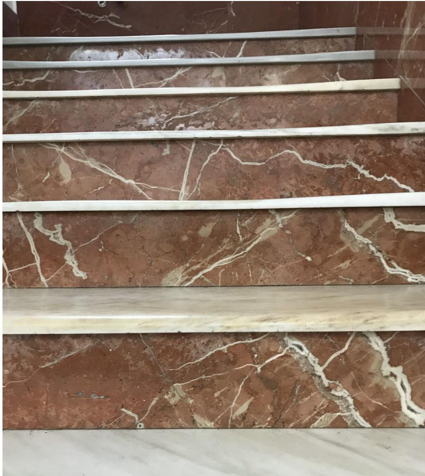
Imagen 21. Significativa pérdida de espesor de las huellas del N.P.E. Fuente: Elaboración propia
