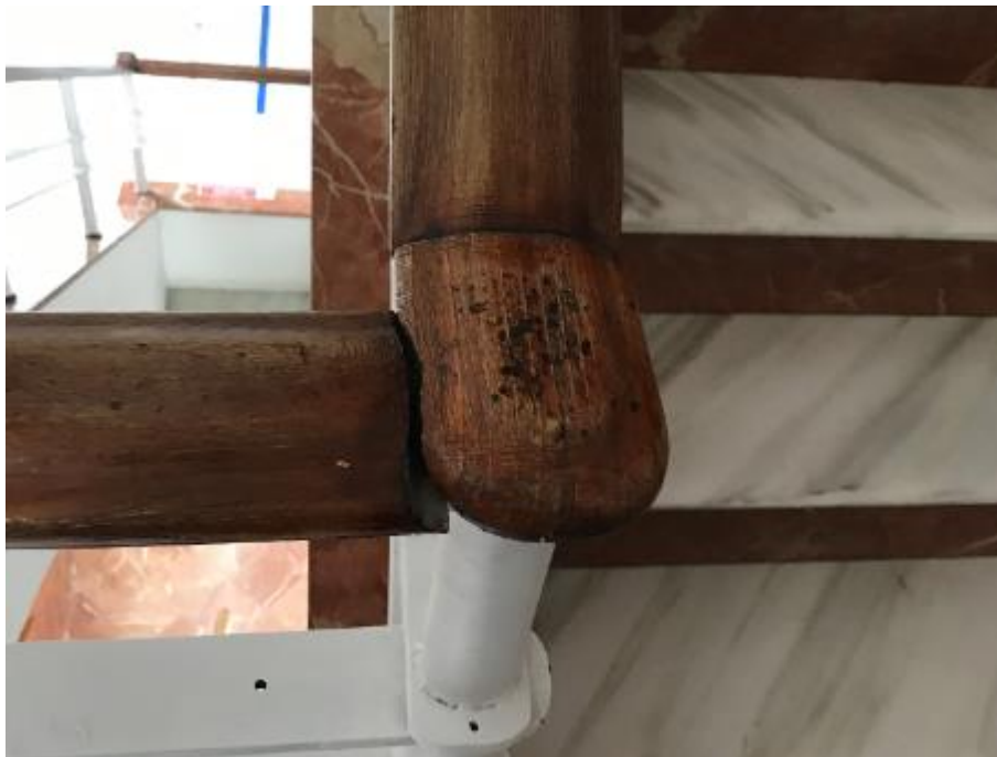
Imagen 22 Desgaste de los tramos de baranda del N.P.E. Fuente: Elaboración propia
