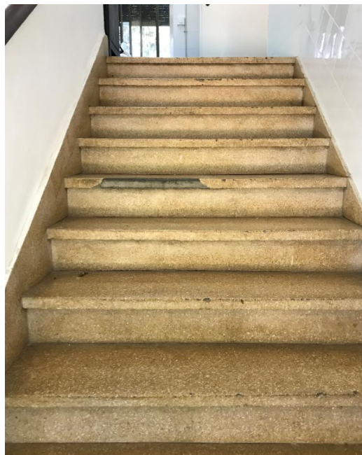
Imagen 41 Considerable deterioro de la zona de escalera. Fuente: Elaboración propia.
