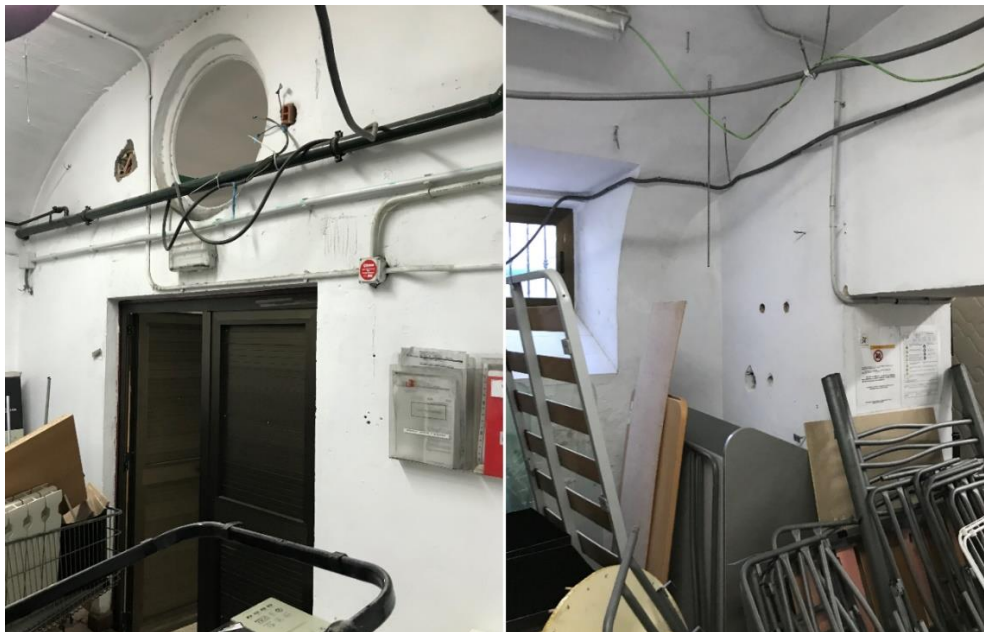
Imagen 49 Estado actual de la sala de calderas de la planta sótano. Fuente: Elaboración propia.
