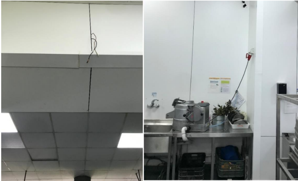
Imagen 40 Distribución actual de la instalación eléctrica que se plantea mejorar. Fuente: Elaboración propia.
