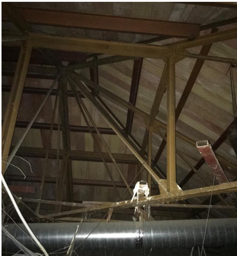
Imagen 31 Cubierta sin aislamiento del castillete central del edificio. Fuente: Elaboración propia.
