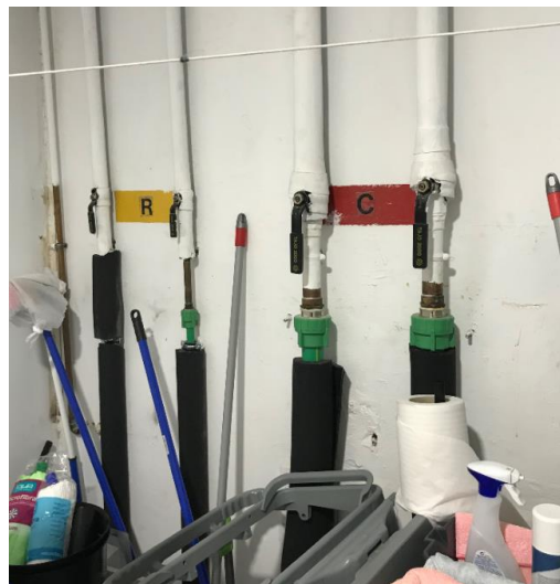
Imagen 45 Diferencia del material de la instalación de agua en la tercera planta. Fuente: Elaboración propia.
