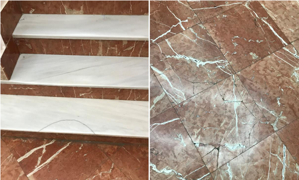
Imagen 52 Estado actual de los revestimientos del núcleo principal de escaleras. Fuente: Elaboración propia.
