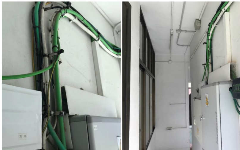
Imagen 42 Caos en CSMP ubicado en el castillete de la cocina. Fuente: Elaboración propia.
