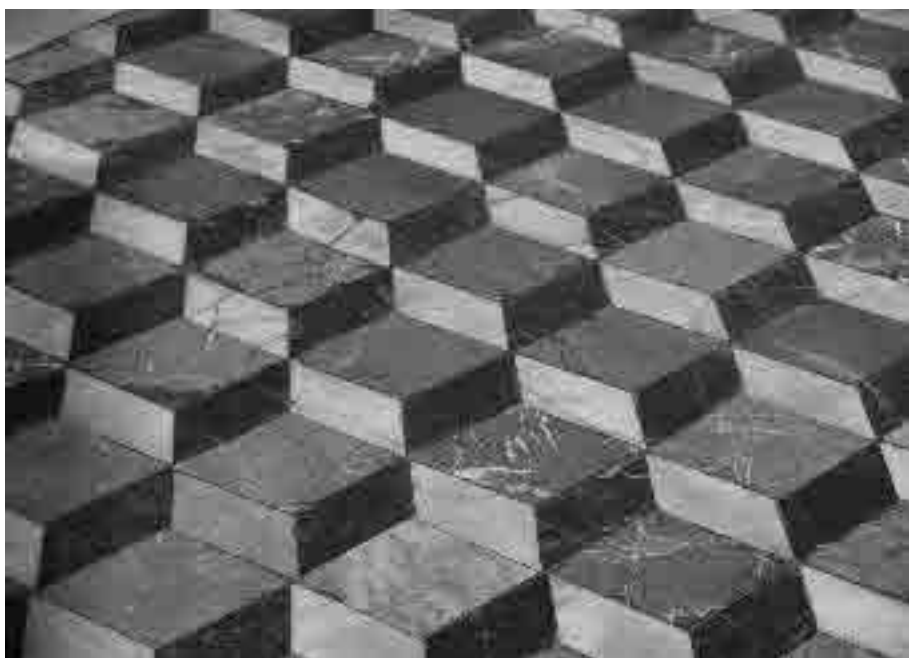
Lám. 10. Pavimento del presbiterio de la iglesia prioral de El Puerto de Santa María (Cádiz), Cosme Velázquez, 1817-1828.
