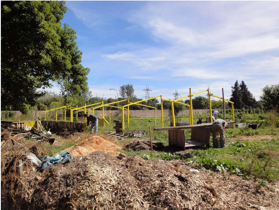
Figure 9 : Construction d'un abri ombragé dans le jardin du PAU du Hogar Español
