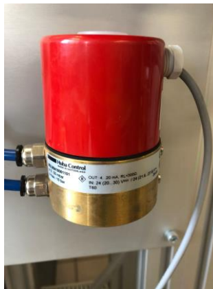
Figura 4.1 Sensor de nivel instalado
